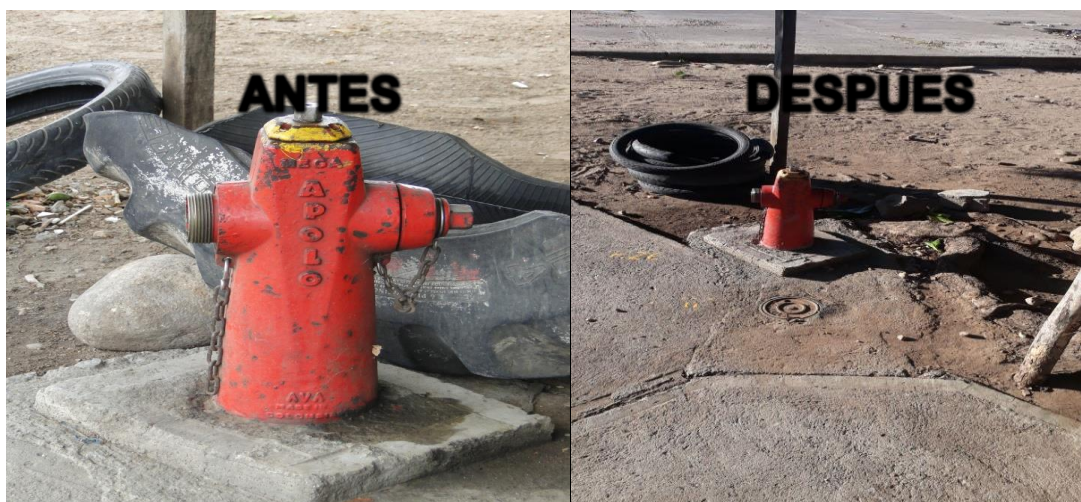
Hidrante ubicado en la calle 16c, frente al estadio de softbol.
