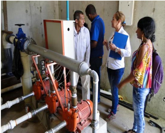
Capacitamos y apoyamos a las comunidades de vivienda gratuita; Lorenzo Morales, Nando Marín en los procesos de adaptación y cuidado del agua y el uso de las Hidrobombas para evitar el desperdicio
